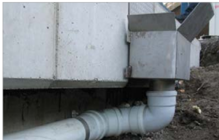
Üblicher FÜK-Einlauf aus Edelstahl (Korrosionsproblem!)
